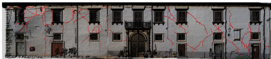
Figura 6 – DSM ed elaborazioni tradizionali: quadro fessurativo
