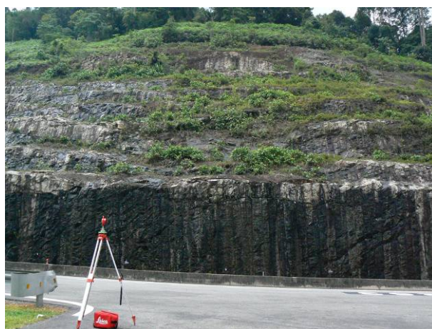
Figura 9 - Diffusa vegetazione nella parte superiore delle pareti
