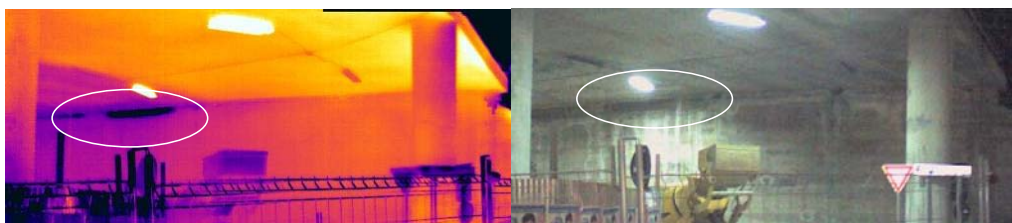
Figura 11 – Ingresso galleria. A sinistra l'immagine Termica IR (TIR). A destra la stessa immagine nel visibile. L'area mostra un'infiltrazione d'acqua.
