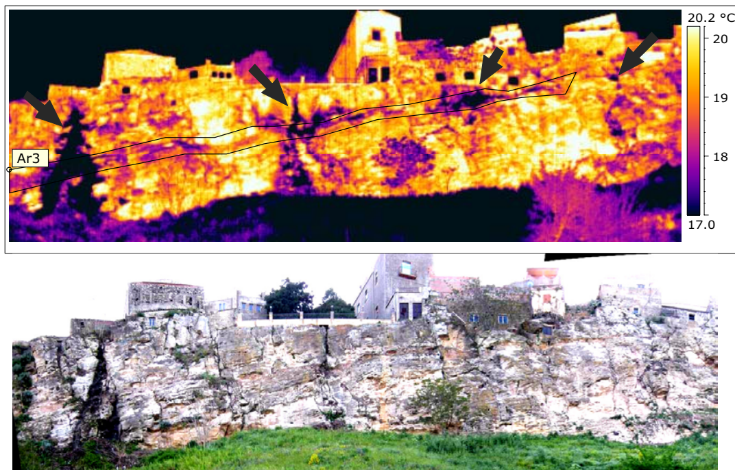
Figura 8 – Versante roccioso. In alto l'immagine Termica IR (TIR). In basso l'immagine nel visibile (VIS). Le frecce indicano la presenza d'acqua di scarico sia superficiali che interne all'ammasso roccioso, mentre l'area Ar3 mostra la presenza di acqua di percolazione lungo una linea di discontinuità primaria.
